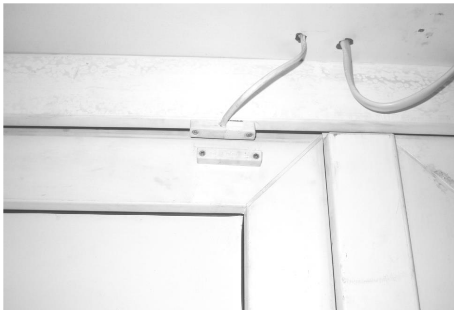
Установка датчика открытия двери
